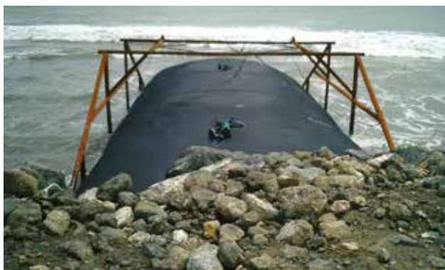
Pripildomą „TenCate Geotube®“ sistemą vietoje laiko metalinis rėmas.
