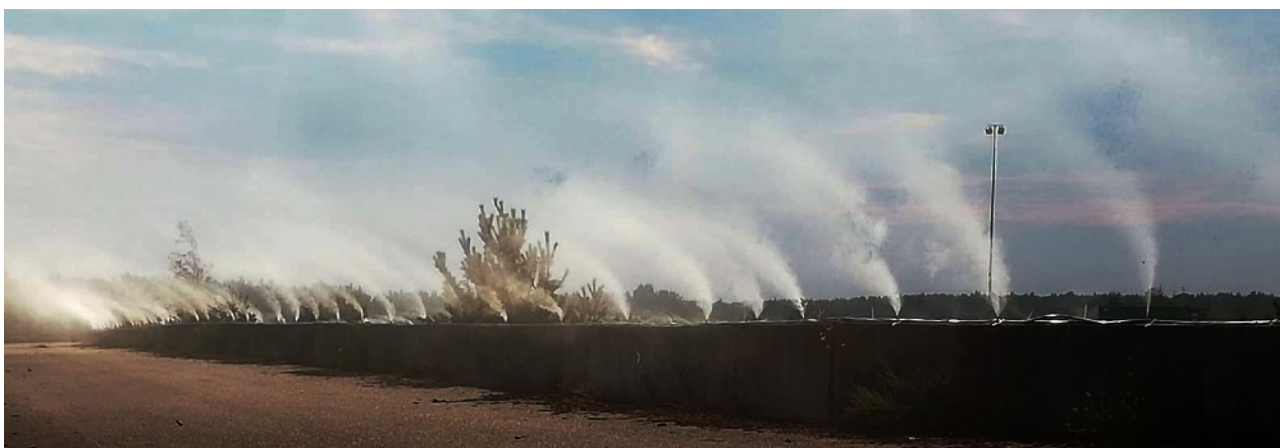
3 Pav. Perimetrinė rūko sistema
